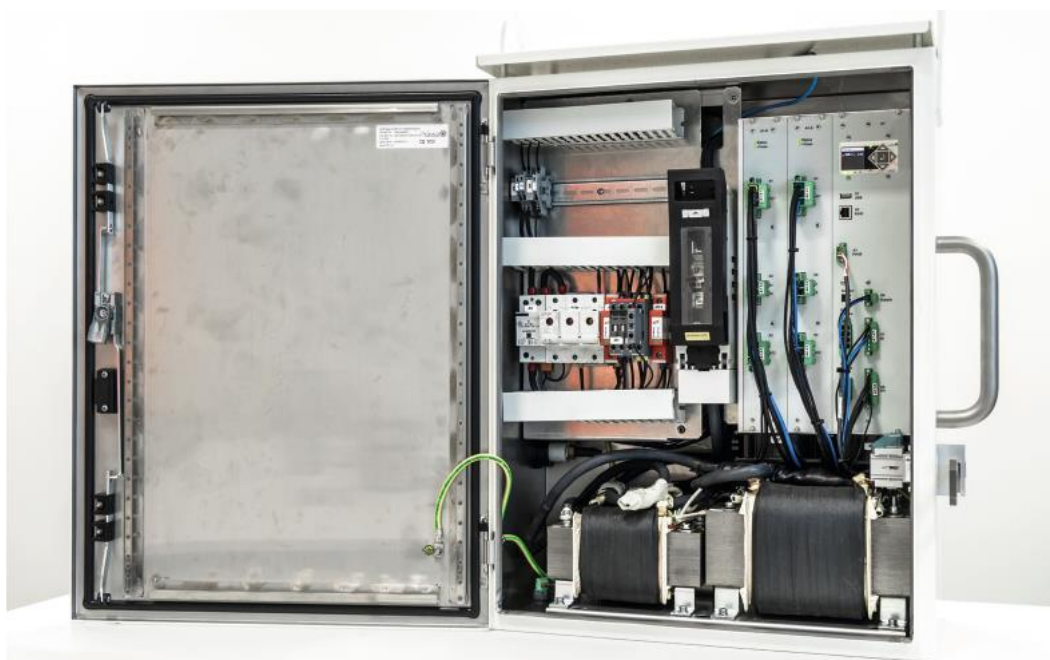
Slika 12. Regulator napona s dva transformatora i tiristorima [5]
