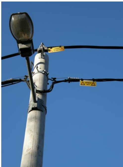
Slika 4. Vođenje srednjenaponske i niskonaponske mreže na istom betonskom stupu [2]
