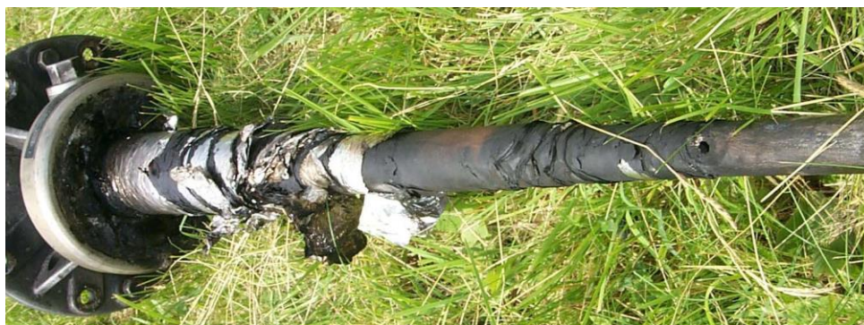
Slika 1. Rasprsnuće gornjeg tijela transformatorskog provodnika
