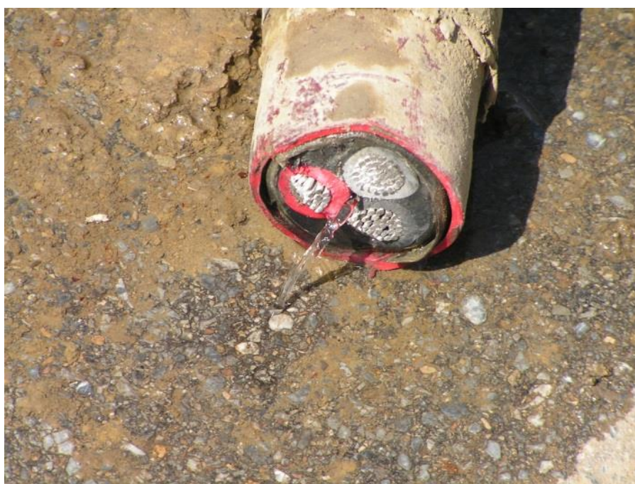
Slike 3. i 4. Kabel u koji je prodrla voda.
