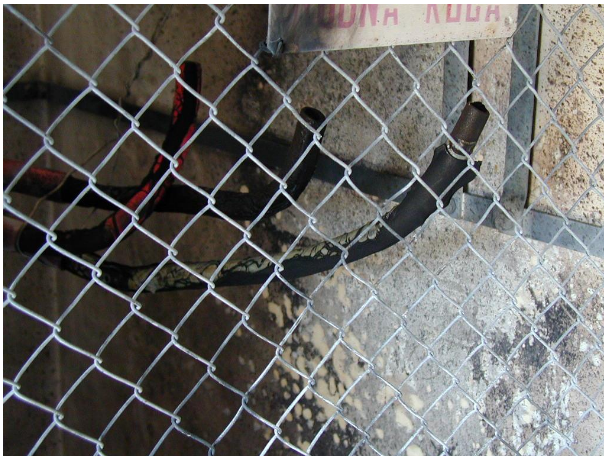
Slika 6. Kabelski završetak nakon eksplozije
