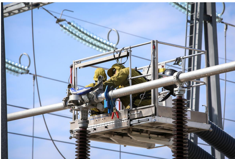
Slika 14. Pregled sabirnica 400 kV na potencijalu, s izolirane platforme
