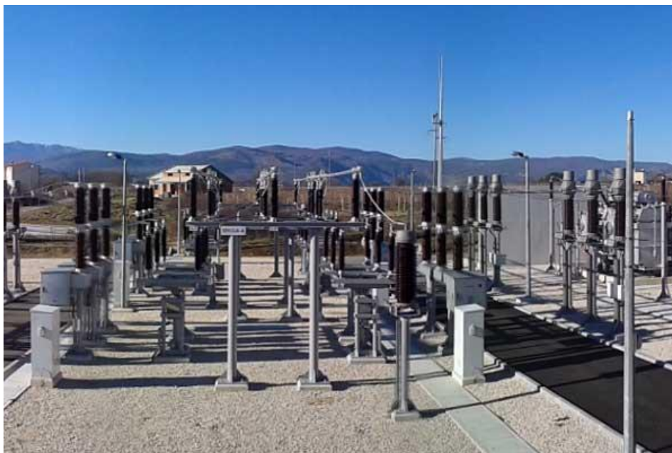
Slika 2: Izgled klasičnog visokonaponskog vanjskog postrojenja
