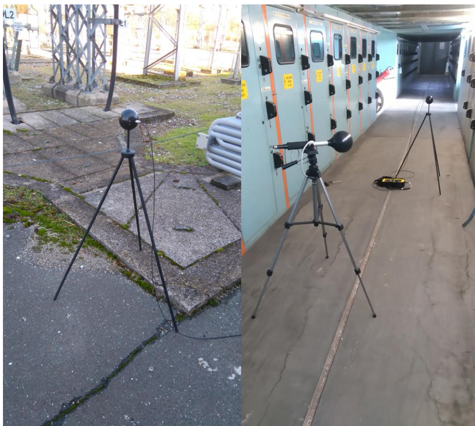
Slika 4: Mjerenja elektromagnetskih polja u TS 110/10 kV Sopot
