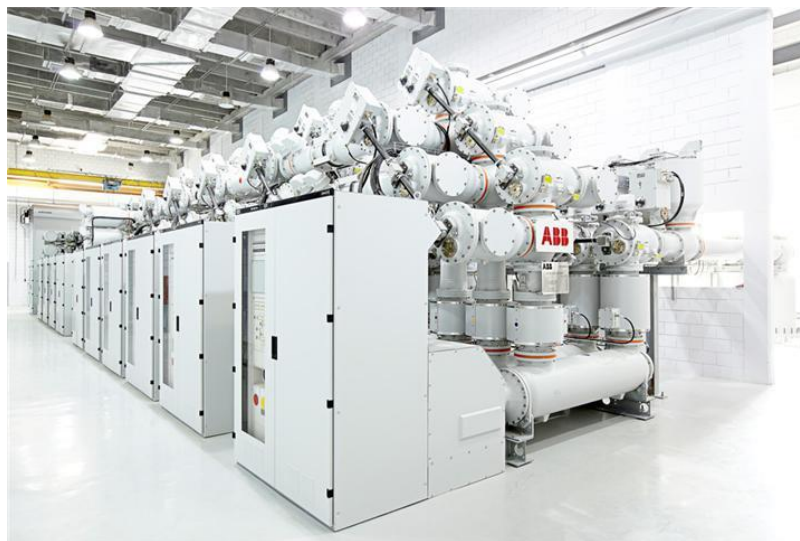
Slika 1: Izgled visokonaponskog GIS postrojenja
