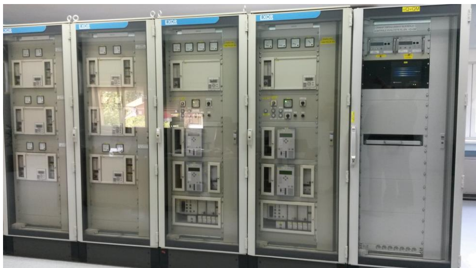
Slika 2. Ormari sekundarne opreme 110 kV polja: vodna polja (lijevo); trafo polja 1 i 2 (sredina); novi ormar obračunskog mjerenja i kvalitete energije (desno)
