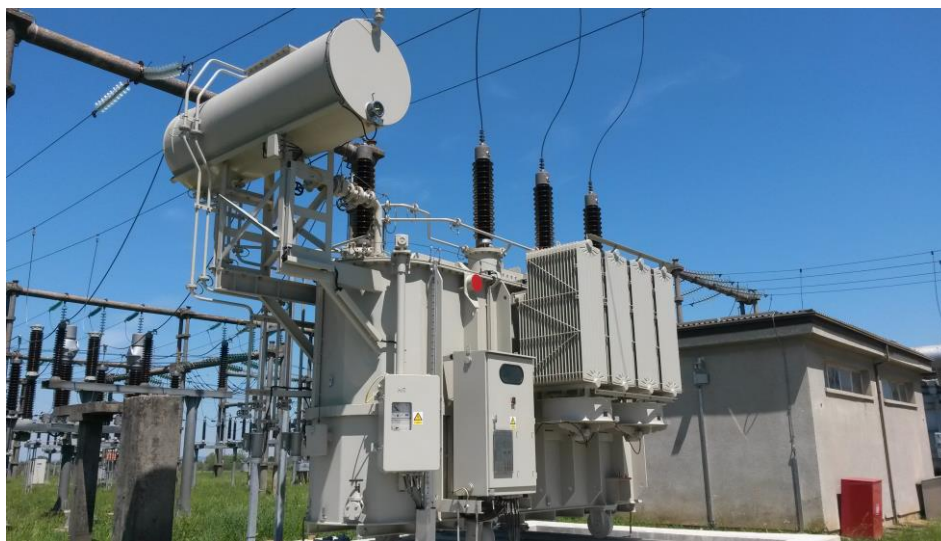
Slika 1. Transformator -TR1 110/20 kV – nadležnost HEP ODS
