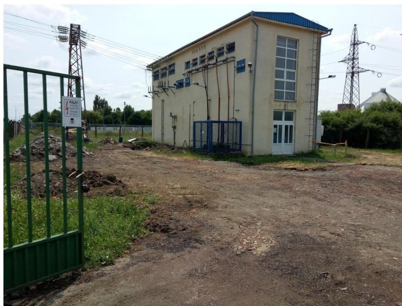
Slika 2. trafostanica TS 35/10(20)kV Županja 1 - rekonstrukcija
