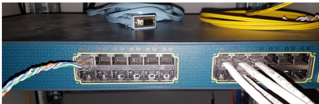
Slika 5. preklopnik HEP WAN mreže u postrojenju
