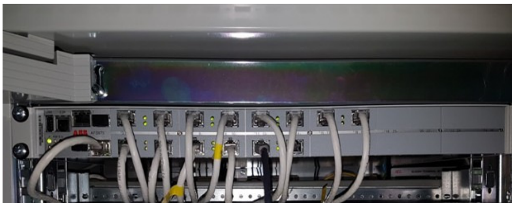
Slika 4. preklopnik za IEC61850 u postrojenju
