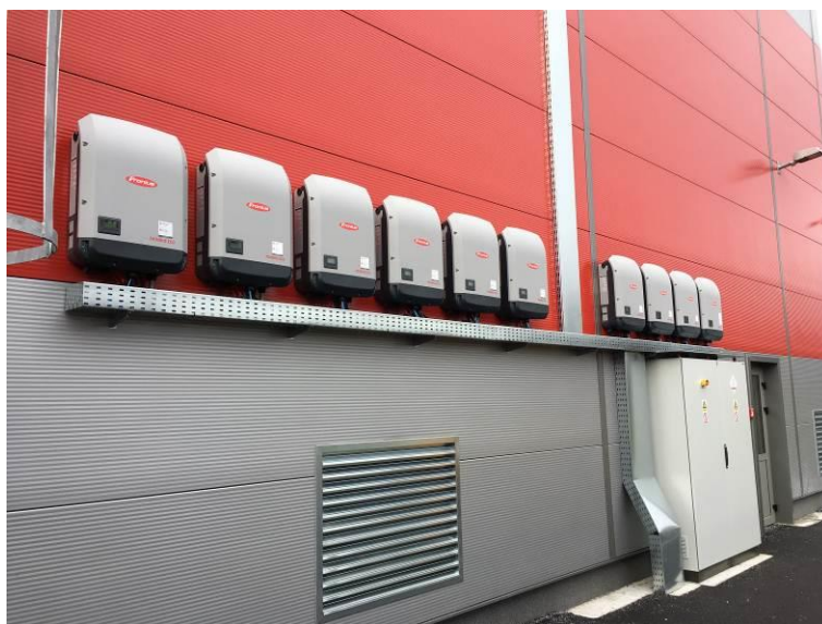
Slika 3. Primjer instalacije invertora sunčane elektrane
