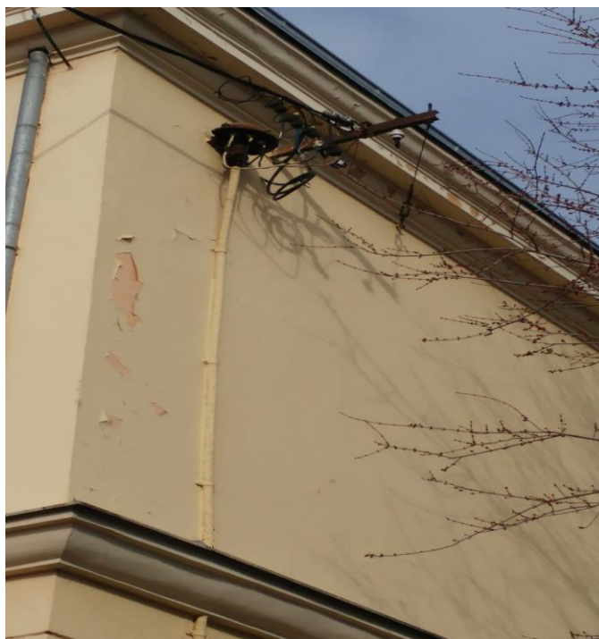
Slika 7. Kabelski završetak niskonaponskog kabela i spoj na nadzemnu mrežu
