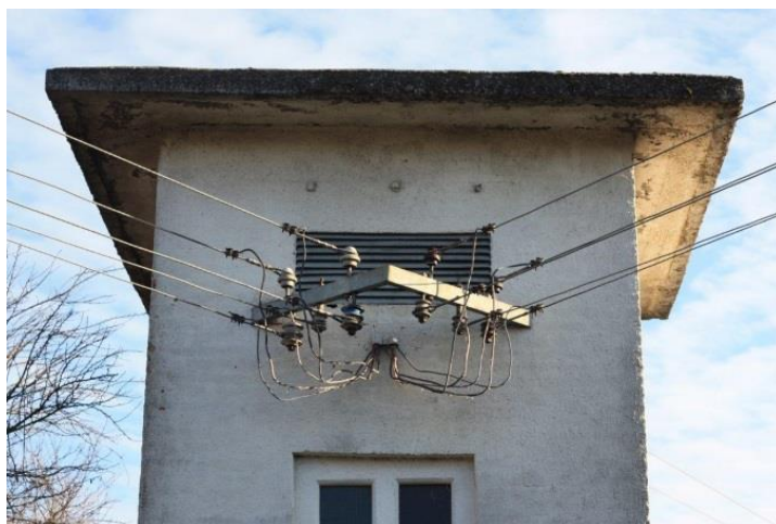
Slika 5. Niskonaponski izlazi iz transformatorske stanice tipa "Tornjić"
