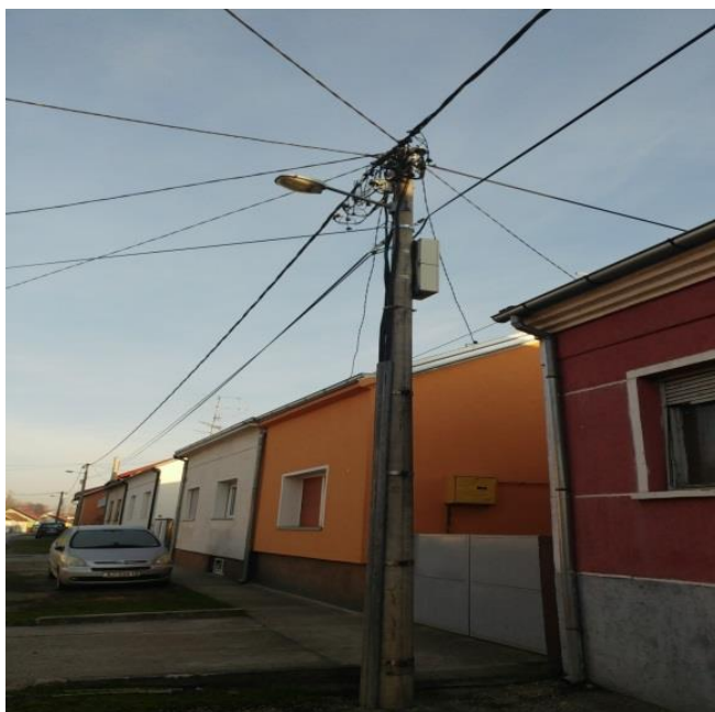
Slika 6. Niskonaponski odvodnici prenapona na izlaznom betonskom stupu
