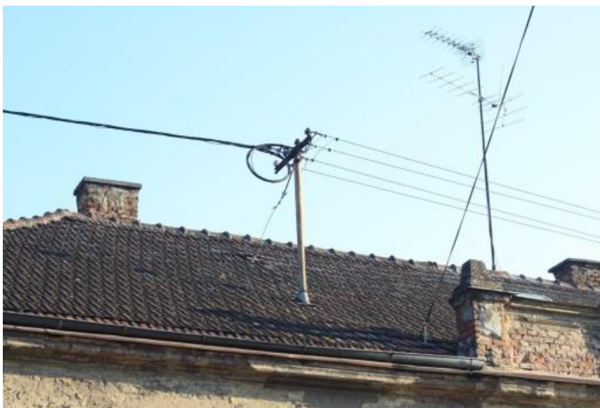
Slika 3. Krovni nosač sa sidrom
