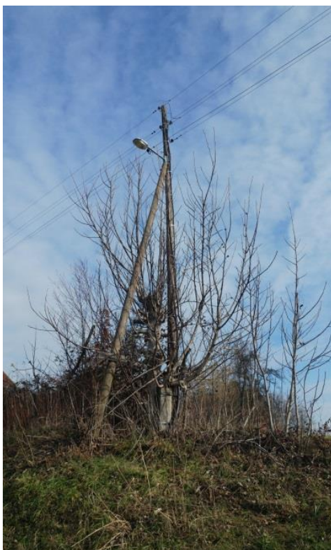
Slika 1. Drveni kutni stup na betonskom nogaru s poduporom i golim vodičima
